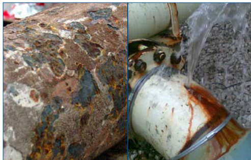
Рис. 1: Повреждения в результате эрозии, коррозии и питтинга. Протечка из-за сквозного повреждения трубы
