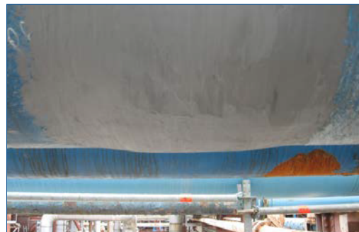
Временное покрытие для участка со сквозными дефектами
